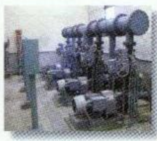
送水ポンプ (鯉江浄水場)
