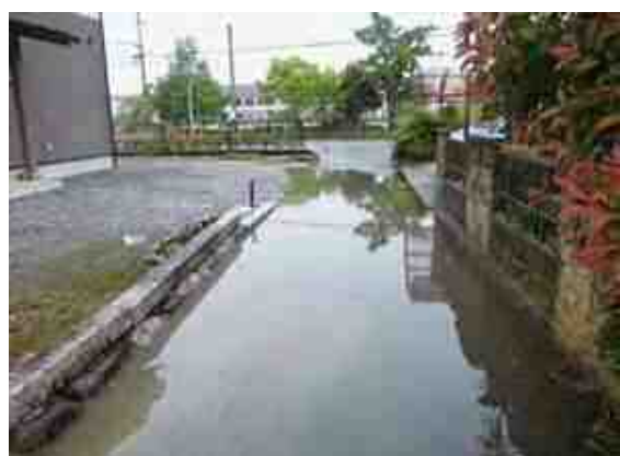
大雨が降ると冠水する里道
