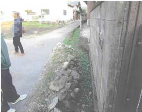
No.7 不良の用水路
