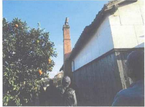
No.3 倒壊の恐れがある煙突
