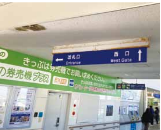
雨漏りやサビが目立ってきた駅舎
