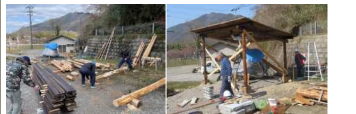
雨・風から守るために、ボランティア活動で屋根を設置。木材は永源寺森林組合から提供していただきました
