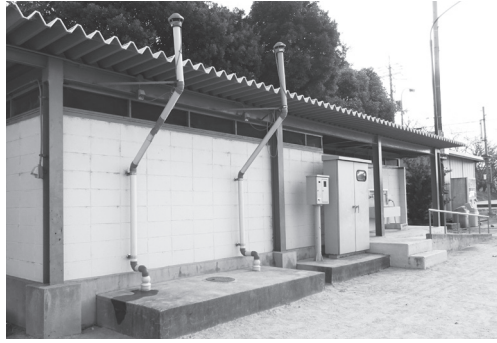
いまだ水洗化されていない運動公園のトイレ
