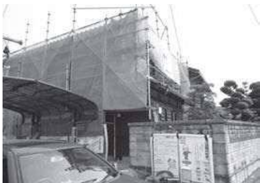
住宅リフォームの推進で需要の掘り起こし
