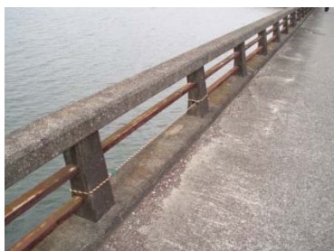
防護柵の老朽化
