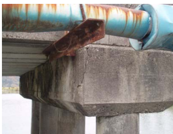
橋台のヒビ割れ
