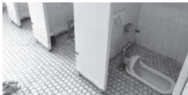
改修が必要な小学校のトイレ
