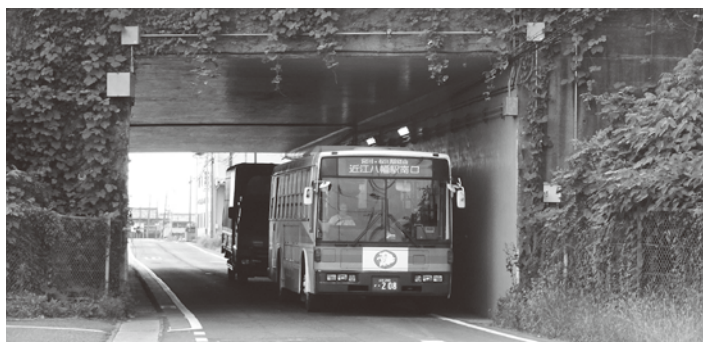
危険な名神高速道路下の通学路
