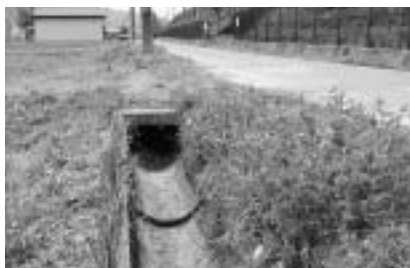
劣化著しい用水施設
