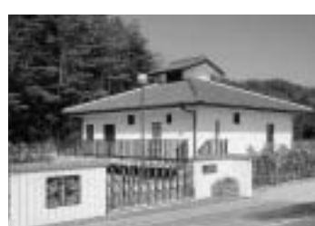
老朽化が進む 農業集落排水処理施設
