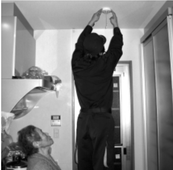
一人暮らしの高齢者を火災から守るため 火災警報機を無料で設置
