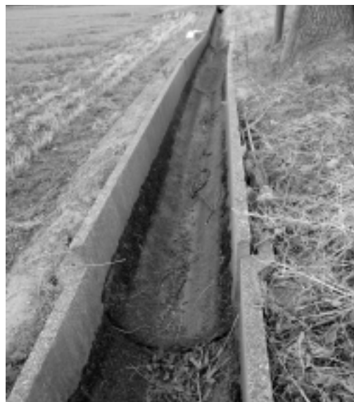
改修が望まれる用水路
