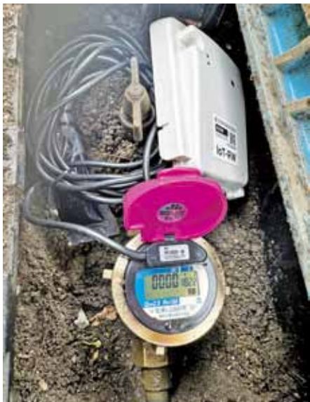
実証実験中のスマートメーター
