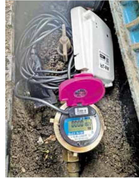
実証実験中のスマートメーター
