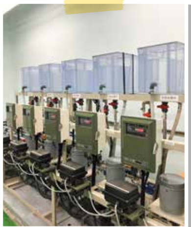
水質監視室（濁度計）
