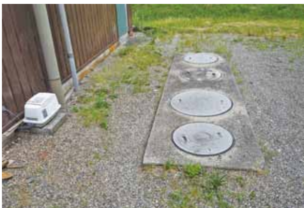
浄化槽本体とブロワー
