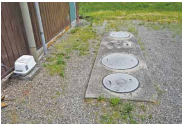
浄化槽本体とブロワー
