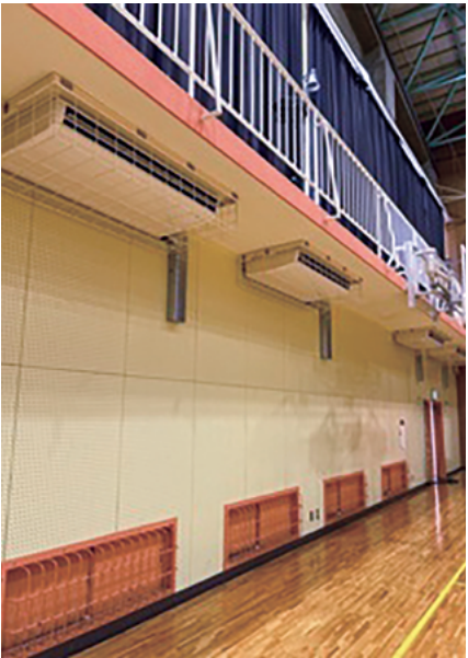
体育館のエアコン設置例
