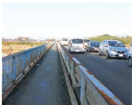
老朽化の目立つ御河辺橋
